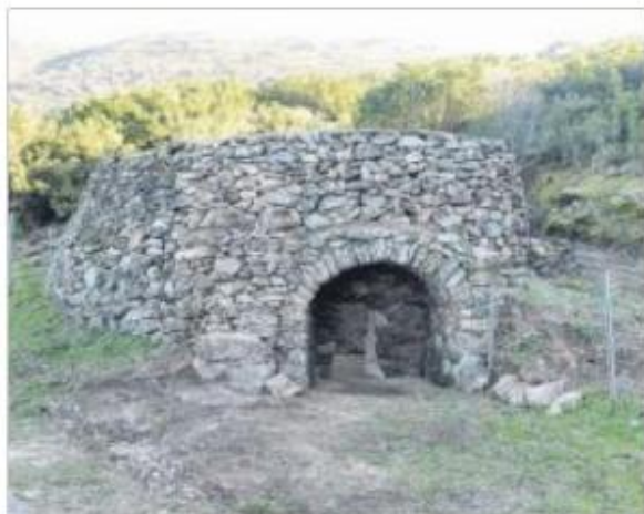
Sur la commune de Palasca, ce four à chaux du seizième siècle était en piteux état avant les travaux de restauration.
