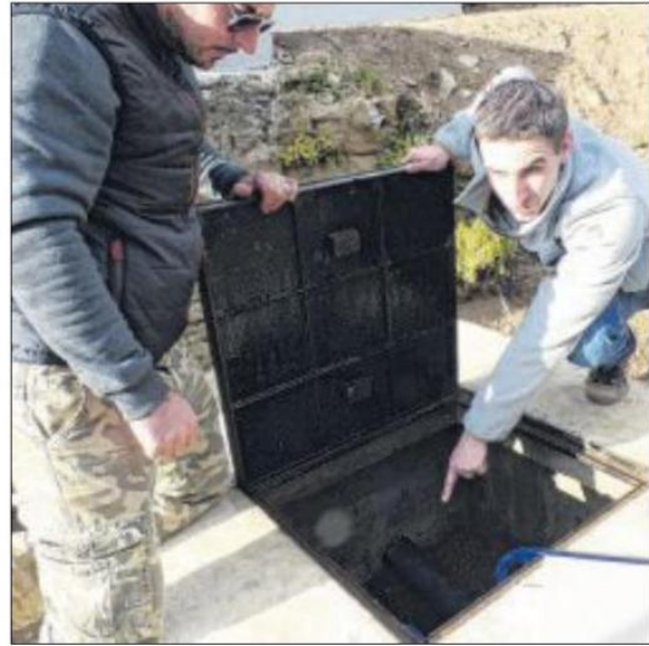
Chaque captage a été maçonné, isolé par une clôture, équipé de vannes et d'un robinet de prélèvement.
