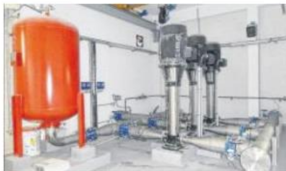
Les nouvelles pompes de la station de Lozari permettent d'alimenter les réservoirs de Palasca et d'Île-Rousse. Ces derniers assurent une autonomie d'approvisionnement de 24 heures.
