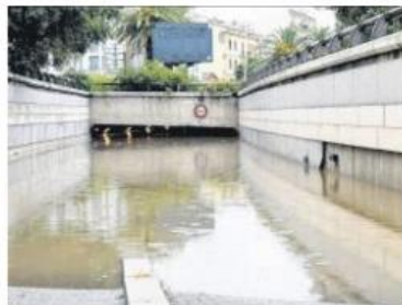
On a mesuré 2,40 mètres d'eau dans le mini-tunnel de Toga !
