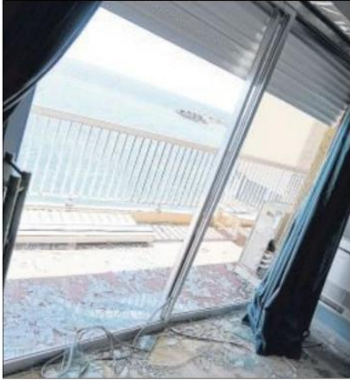
Dans la résidence I Minelli, plusieurs baies vitrées ont explosé sous les effets de la tornade de lundi.
