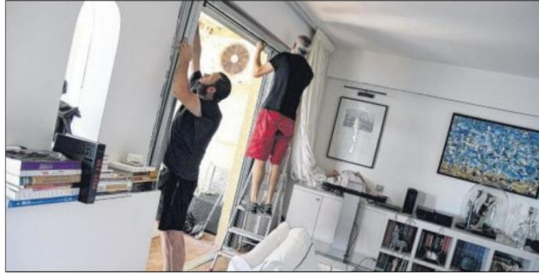
Dans plusieurs appartements de Ville di Pietrabugno, l'heure était hier aux premières réparations.
