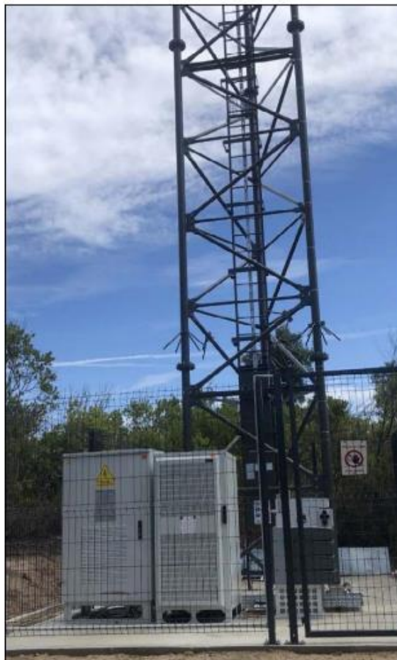
Une nouvelle antenne relais a été installée à Linguizzetta.
