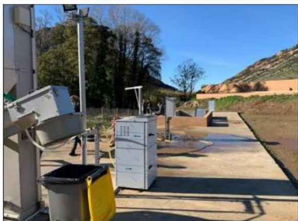
Cette Step nouvelle génération est dotée d'un système d'éco-traitement des eaux usées.
