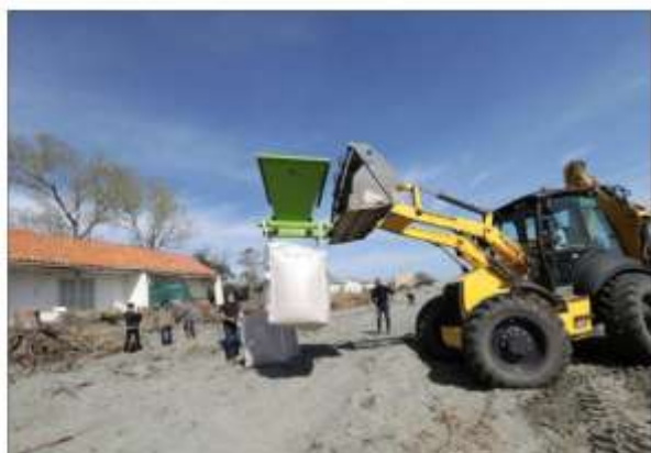
Sept maisons vont être protégées par les sacs, pour un coût d'environ 40 000 €.
