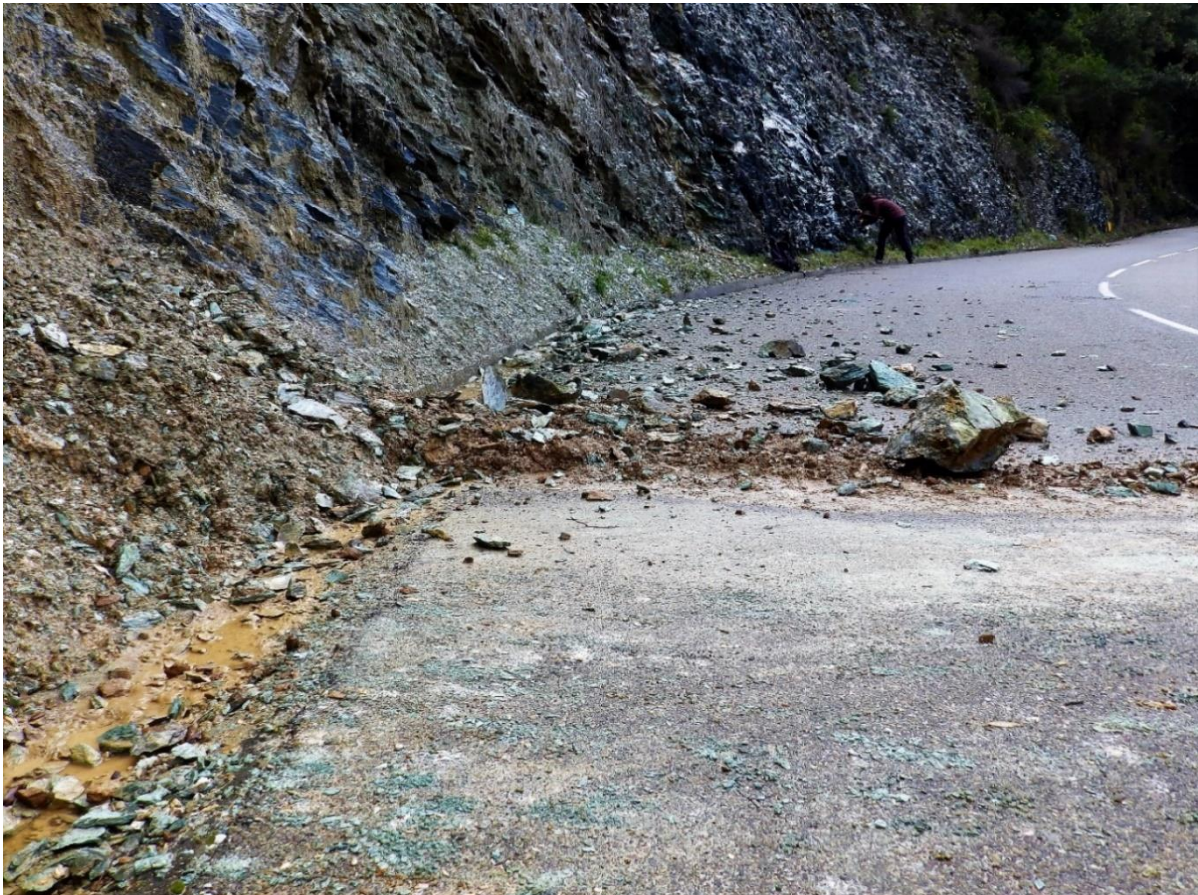
Figure 170 : Chute de pierres affectant des serpentinites cataclastiques très riches en amiante (D80).
