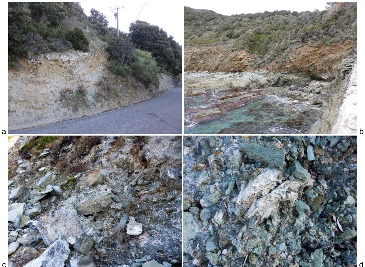
Figure 140 : Importance des colluvions observées dans le talus de la D80, à la sortie nord de Nonza (a : point DL1907), en bord de mer, au sud de Nonza (b : point DL1894) et au nord de Baracataggio (c & d).
