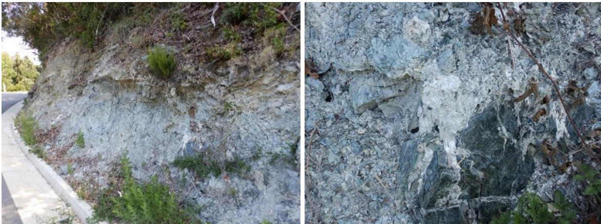
Figure 12 : Talus de la D180 entaillant des serpentinites très amiantifères (point DL0174).
