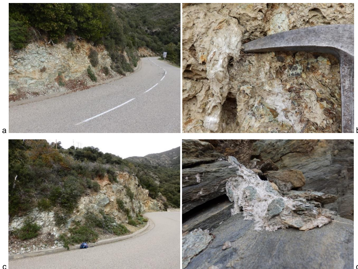
Figure 145 : Exemples d'occurrences amiantifères le long de la D80 (a & b : DL1977 c & d : DL1981).
