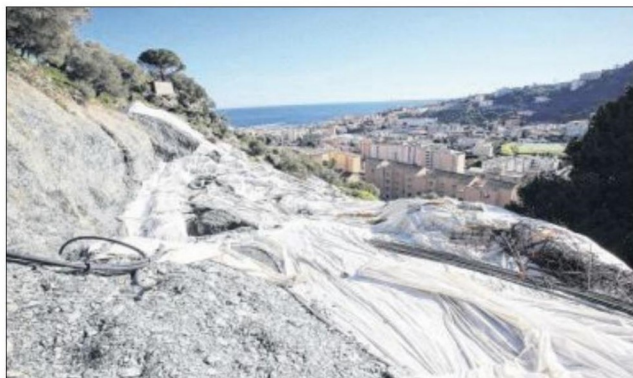
Le chantier de construction "Mandevilla" concernait trois immeubles à l'Annonciade. / ARCHIVES G.B.
