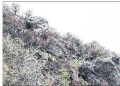
Plus rien pour retenir les blocs de pierres.
